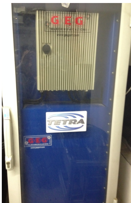
N. 1 APPARATO RACK TETRA
