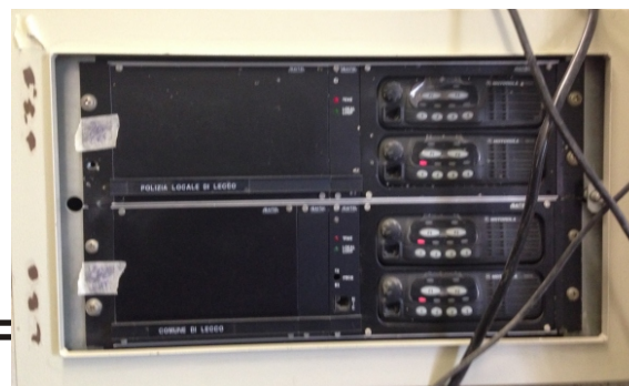
N. 1 APPARATO RACK MOTOROLA
